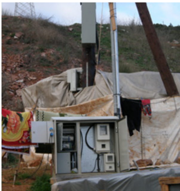
Site d'installation de Roms à Kamilovrysi, en Fthiotide: raccordement électrique
