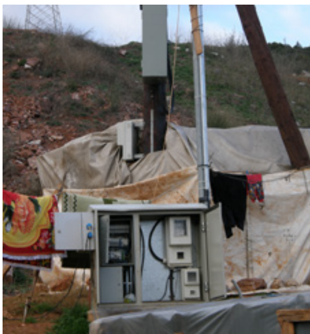
Asentamiento romaní Kamilovrisi Fthiotida: conexiones eléctricas
